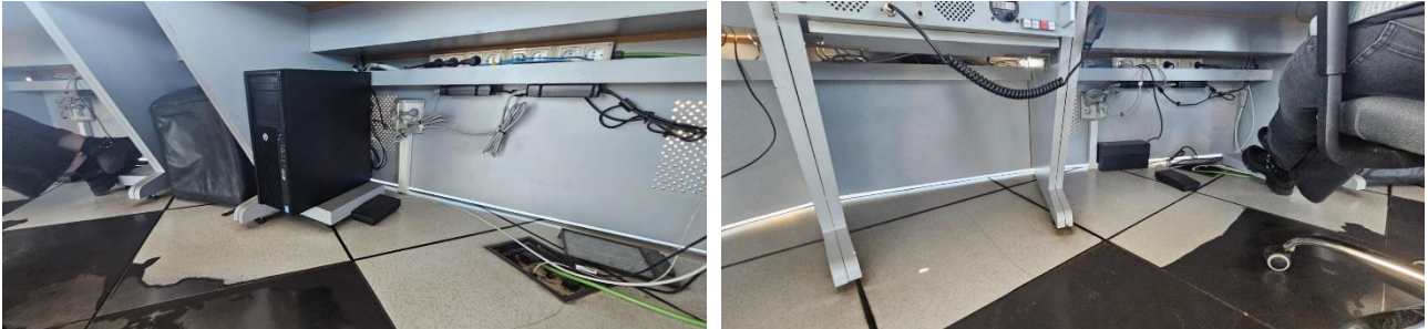
Imágenes ilustrativas del estado actual piso Tecnico de cemento y acero de Cabina de control.
