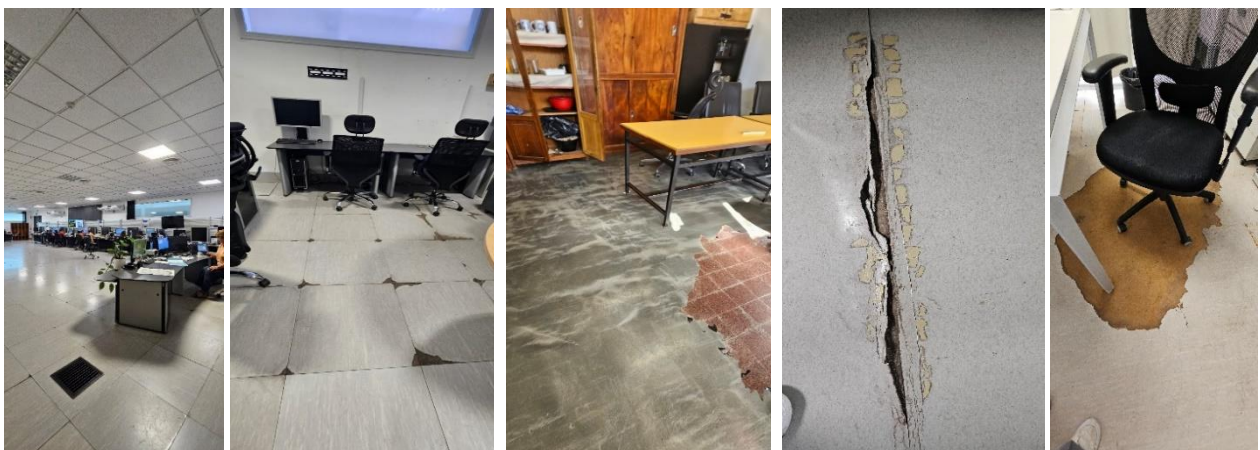
Imágenes ilustrativas del estado actual del piso técnico de madera y vinílico del Edificio Operativo.
