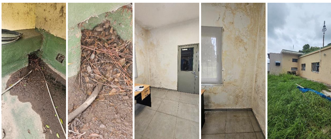
Imágenes ilustrativas de la Planta Transmisora.
